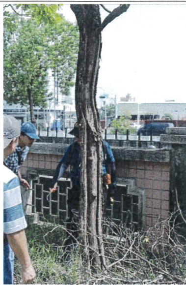
圖 20 第 40 棵風鈴木，主幹開裂腐朽。
