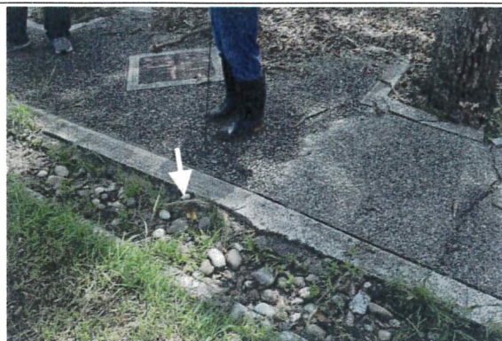
圖 24 黑板樹植穴空間過小，竄根至排水溝(箭頭標示)。
