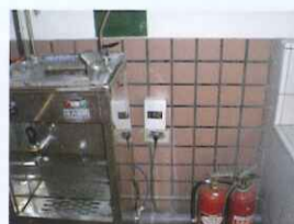
漏電斷路器安裝後照片
