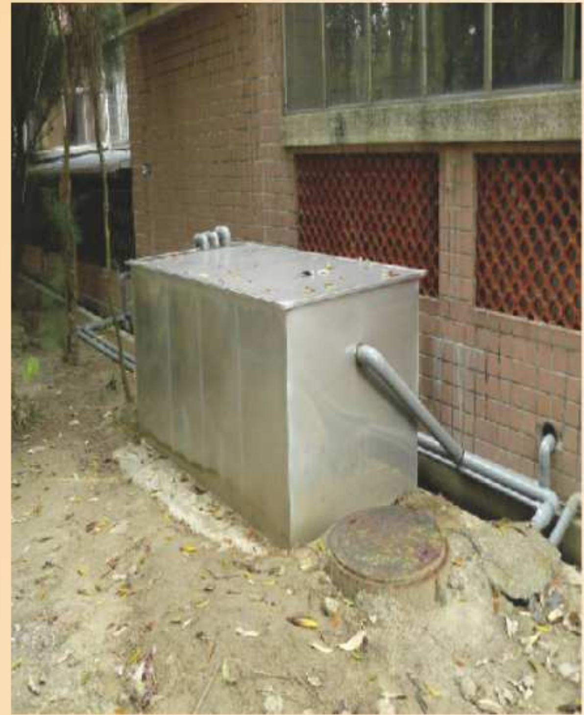
宿舍廚房油水分離設施
