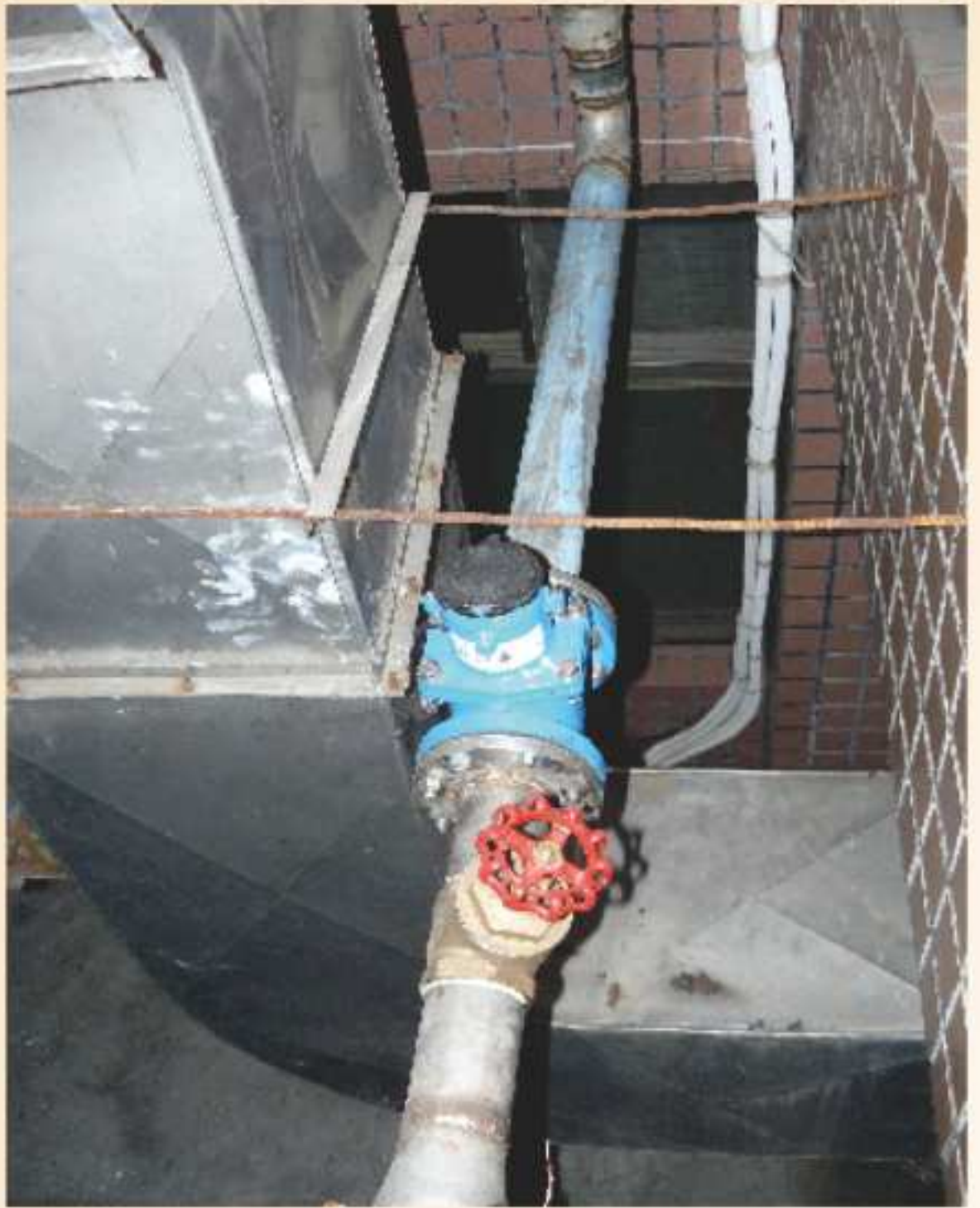
裝設網路式自來水漏水 警示系統裝設後
